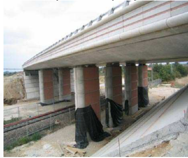
Coque de pile
