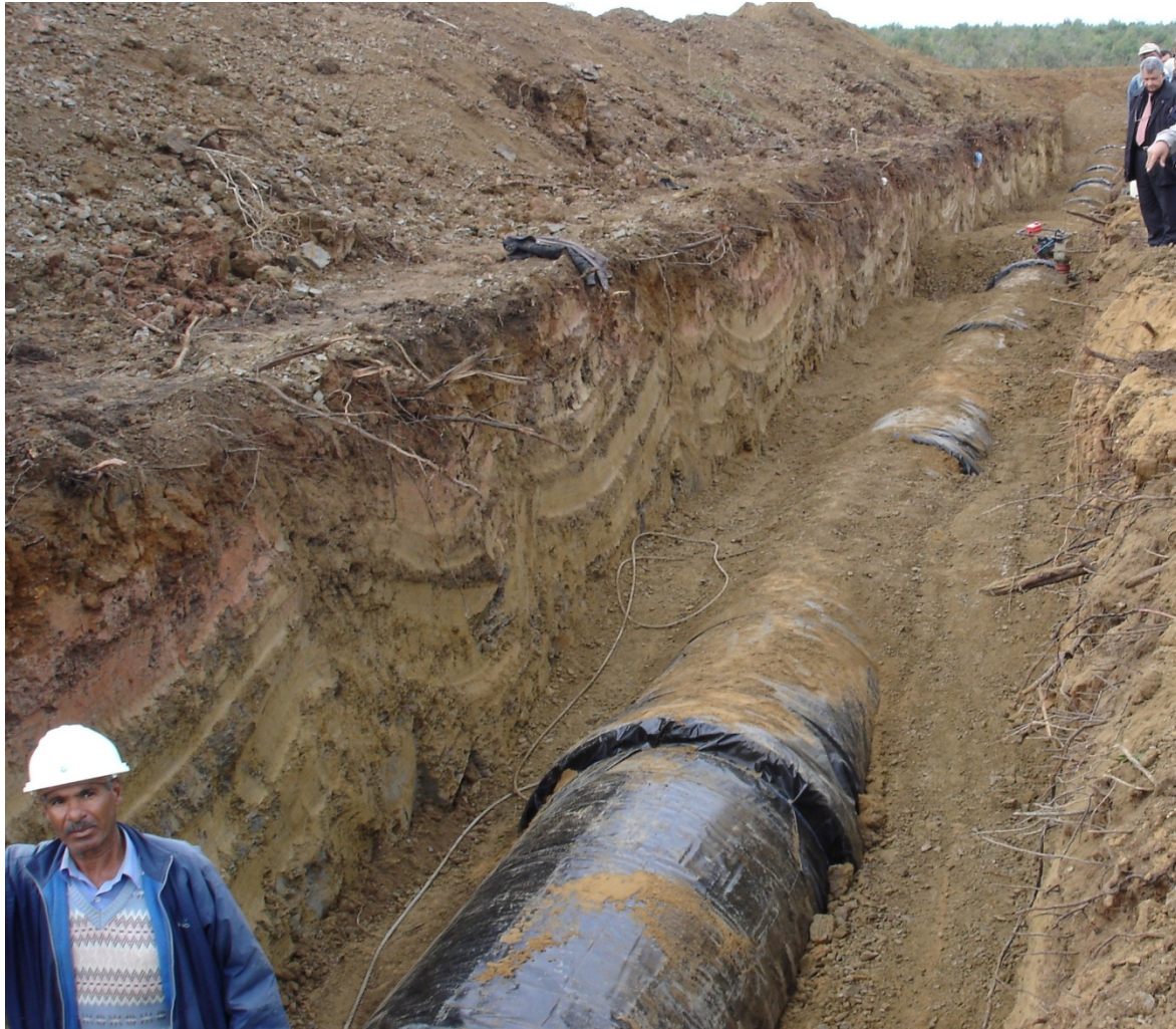
Conduites de refoulement FB 1250 Station de pompage El Harka
