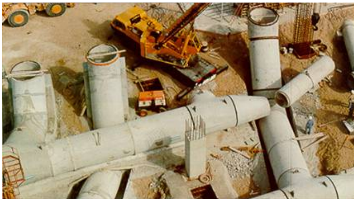
BELLEVILLE (Centrale nucléaire) - Salle des machines Ø 1800 à 3200 mm
